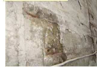
橋台の浮き・鉄筋腐食
