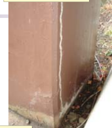
橋脚のひび割れ
